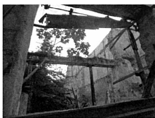
写真6 倒壊する建物
